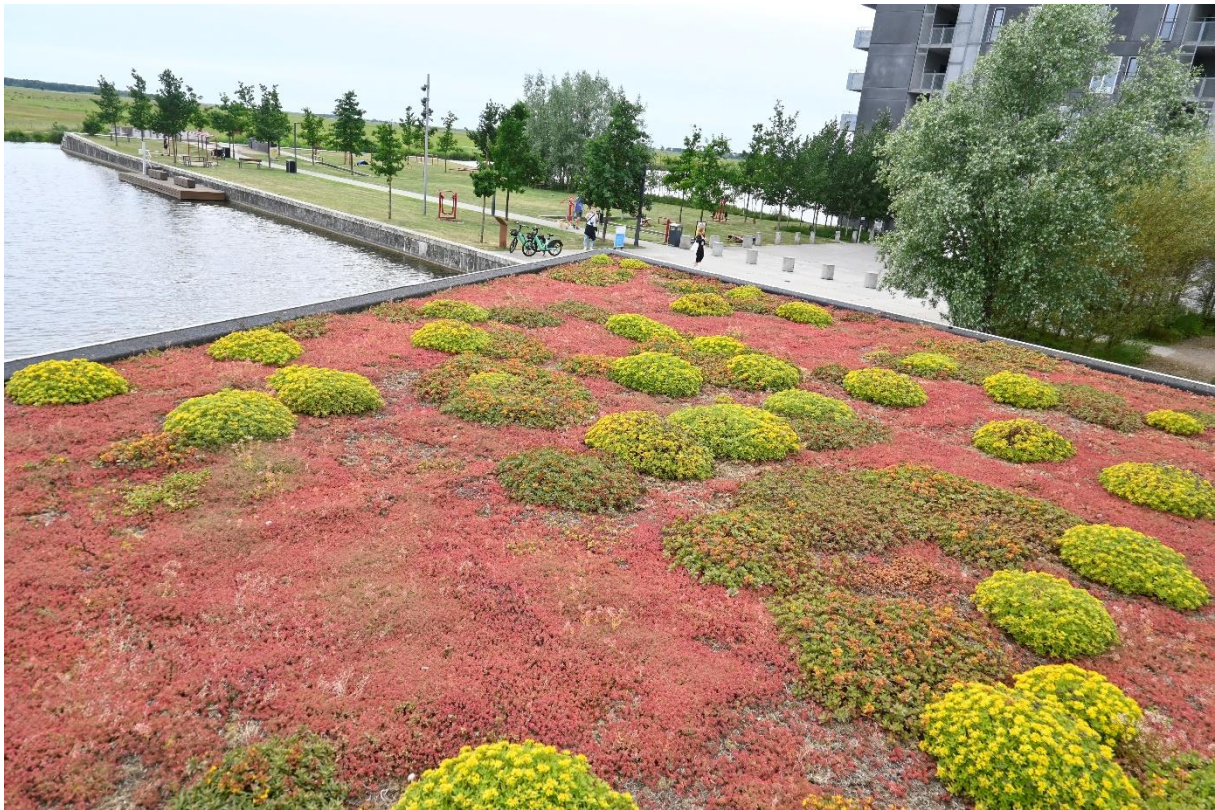
Fot. 11 „Zielony dach na budynku mieszkalnym” – Kopenhaga - Autor: Agnieszka Dudzińska – Jarmolińska
